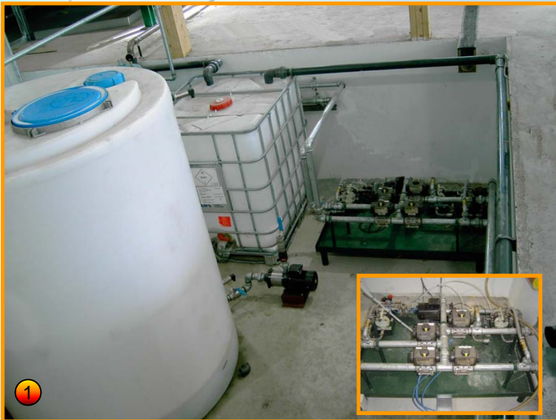
1: Automatisk blandesystem med tilhørende rørføring og filterudstyr
